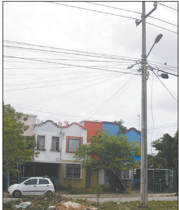
Residentes aseguraron que la CFE no ha acudido a revisar el tendido.
