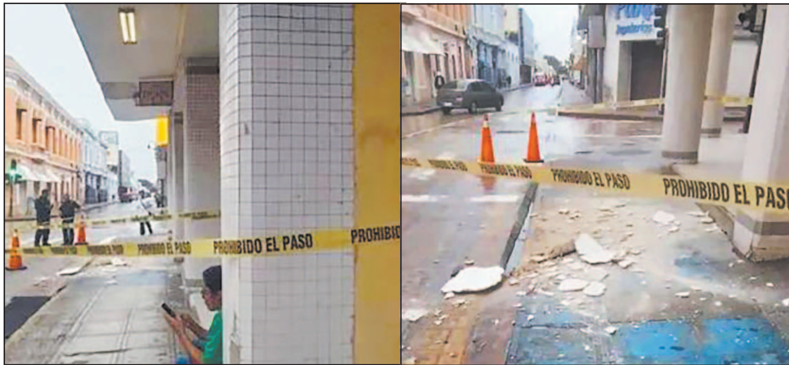
Policías municipales atendieron el reporte y personal de Protección Civil inspeccionó las condiciones de la estructura del establecimiento.
