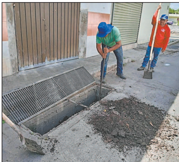
Aumentaron por lo menos en un 30% los trabajos de mantenimiento.
