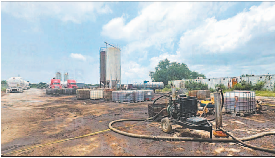
En el operativo se incautaron tractocamiones, frac tanky 409 cubitanques. (Cuartoscuro)
