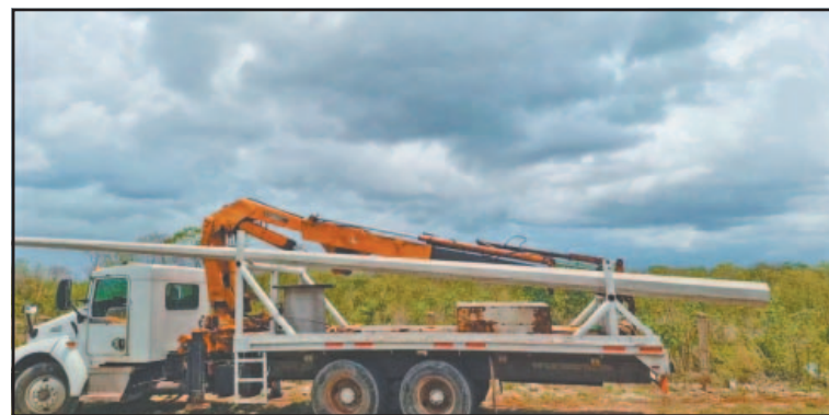
Se requiere del cambio de varios postes que colapsaron. (Amado C.)
