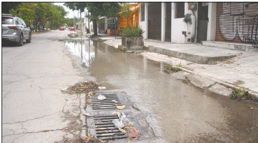
Los habitantes indicaron que debido al problema los accesos a sus viviendas están bloqueados.
