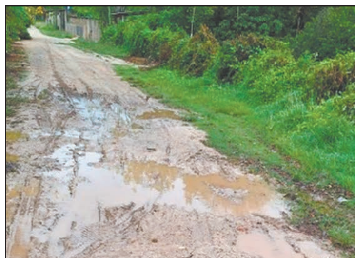
En las áreas bajas registraron acumulaciones pluviales. (Lusio Kauil)
