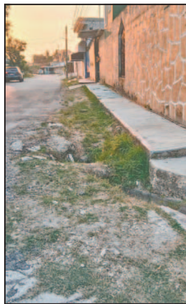
Desde hace un año solicitaron las reparaciones necesarias.
