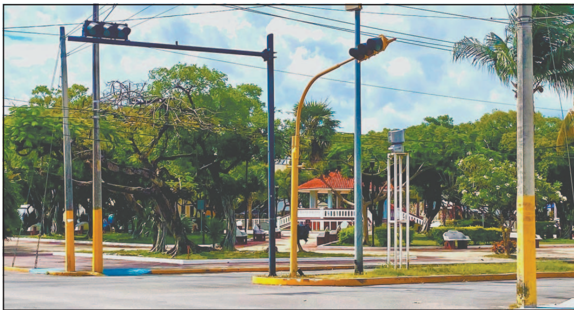
Tránsito admitió que las interrupciones se relacionan con problemas eléctricos y el sistema de control. (A. Blanco)
