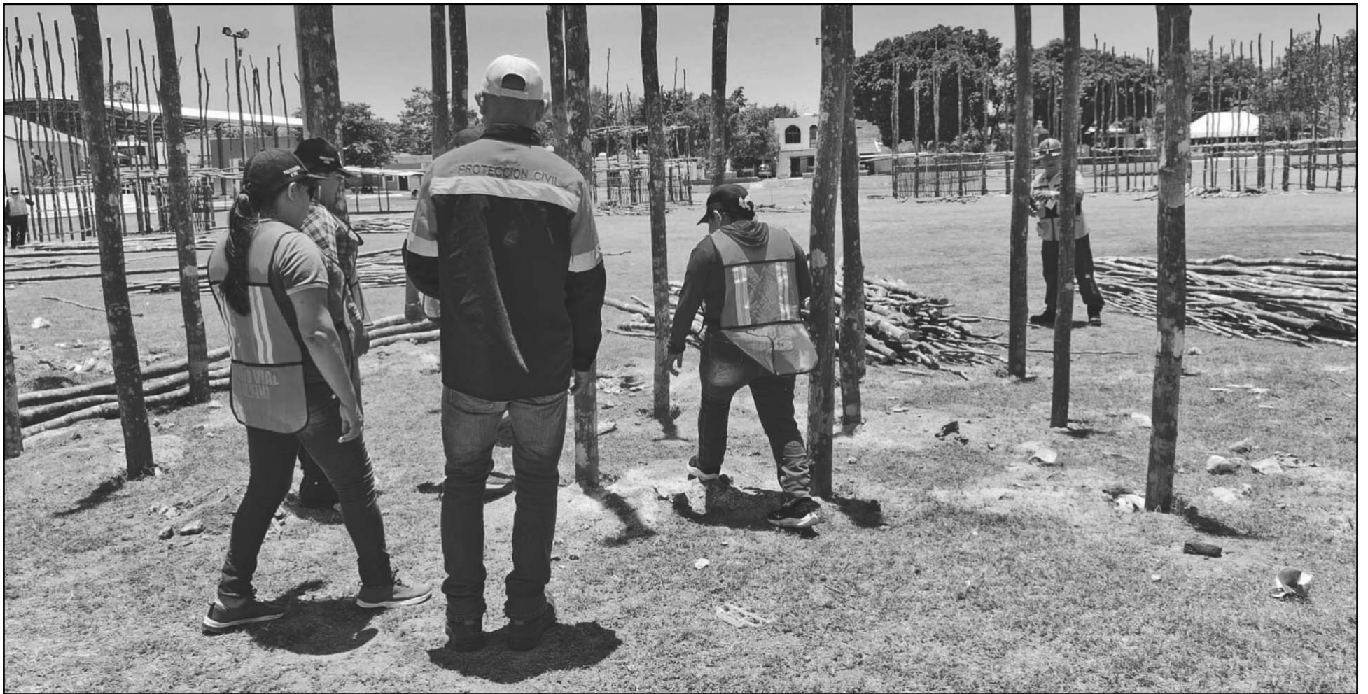
La edificación de hasta tres niveles presentó un armado deficiente en sus bases, informaron los inspectores municipales, que pidieron correcciones inmediatas. (Erik Caamal)
