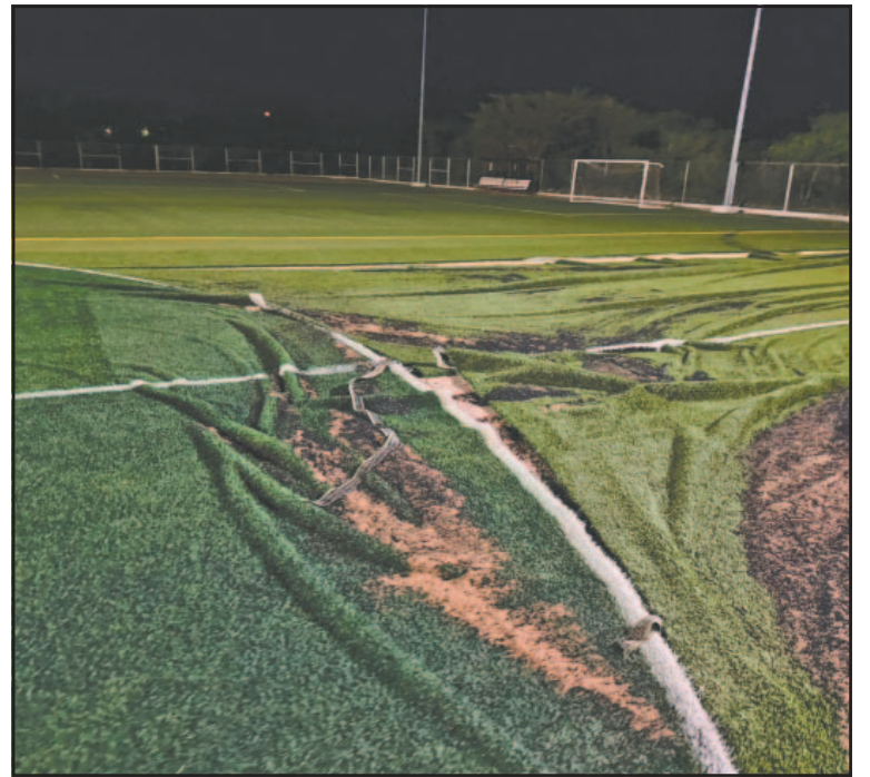
El pasto sintético presentó fallas a solo cuatro años de su construcción.
