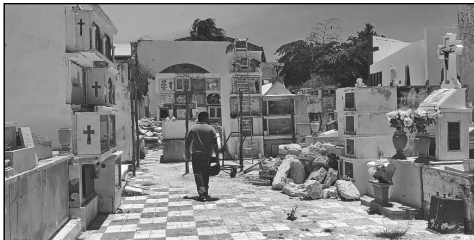
El cementerio de San Román muestra deterioro, incluyendo el colapso de un arco.
