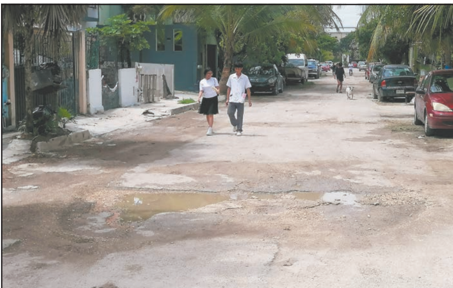
La principal demanda en fraccionamientos es la repavimentación integral de zonas anegadas.
