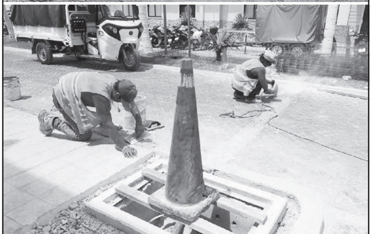
Residentes señalaron desniveles y acabados deficientes. (Fotos O. López)
