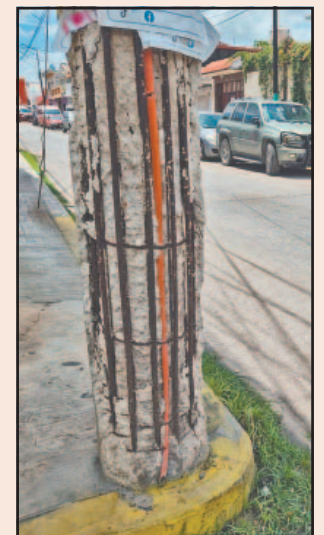
El problema ya se reportó, pero la CFE no lo atiende.
