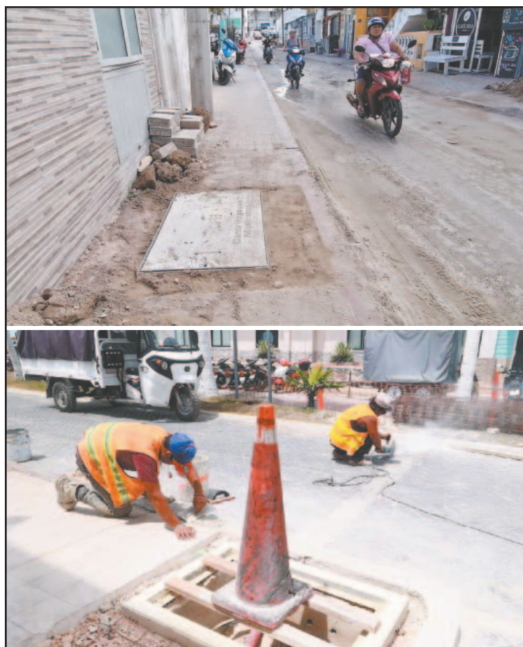
Residentes señalaron desniveles y acabados deficientes. (Fotos O. López)
