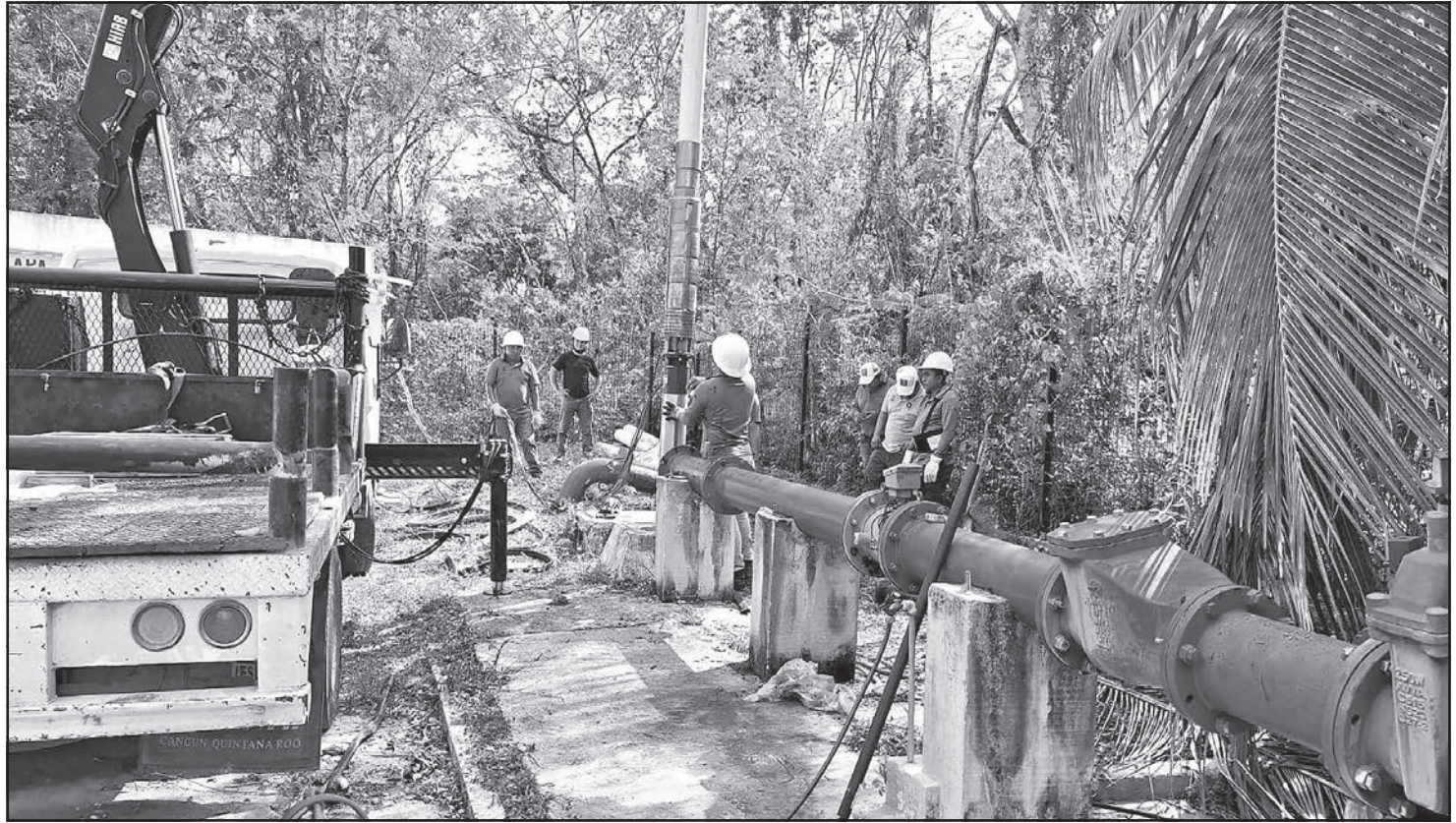
En la ciudad, una planta generadora mantiene en operación el sistema del Pozo 1, ubicado en la colonia Lázaro Cárdenas. (Justino Xiu)
