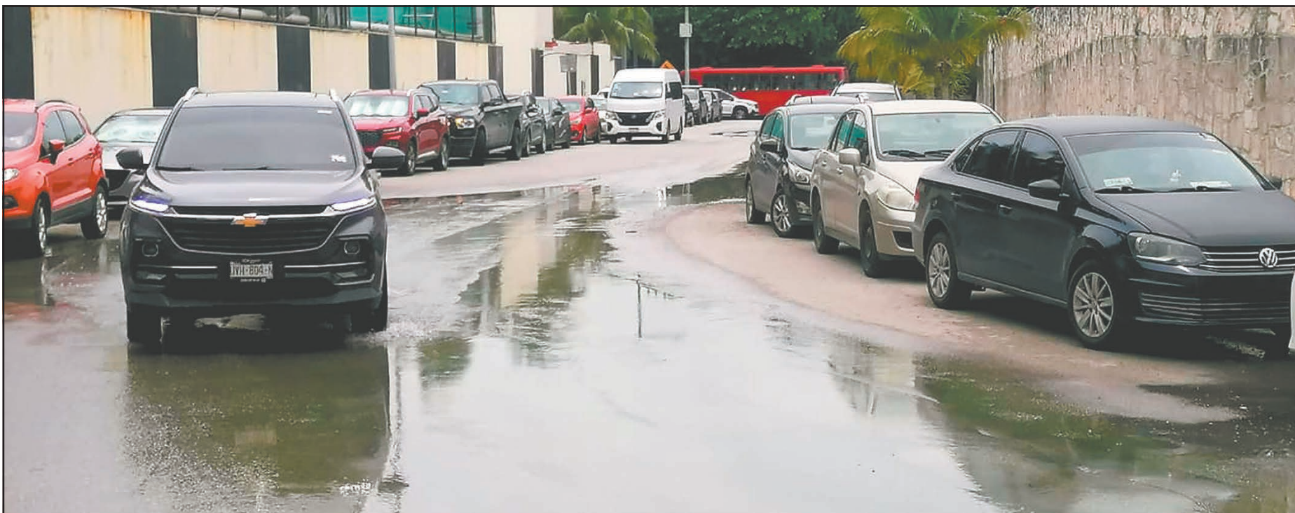
El acumulación de líquido bajo el pavimento está deteriorando la vialidad y, a su vez, el suelo se ha cubierto de limo, lo que genera una superficie resbaladiza para los neumáticos.
