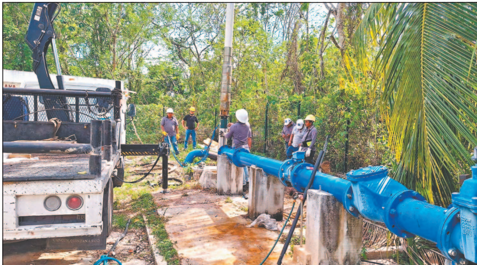
En la ciudad, una planta generadora mantiene en operación el sistema del Pozo 1, ubicado en la colonia Lázaro Cárdenas. (Justino Xiu)
