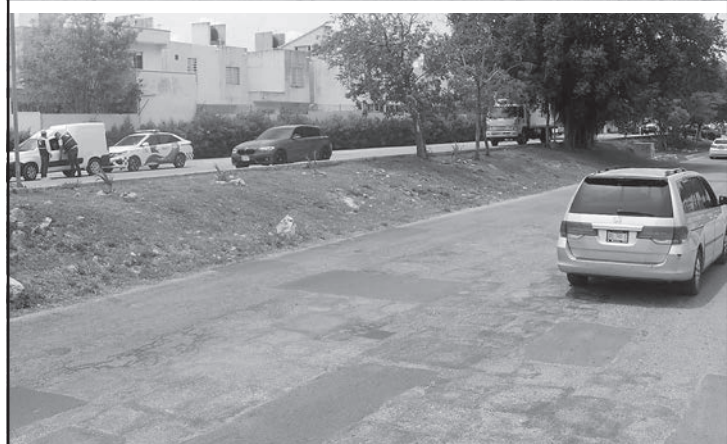
La vialidad tiene tramos fracturados y áreas resbalosas. (Fotos E. Romero)
