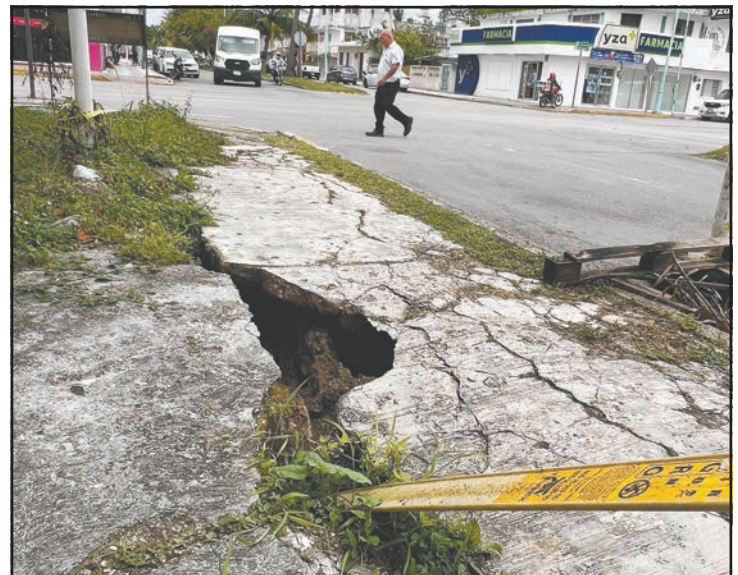
Alertaron que las grietas se extendieron en las últimas semanas.
