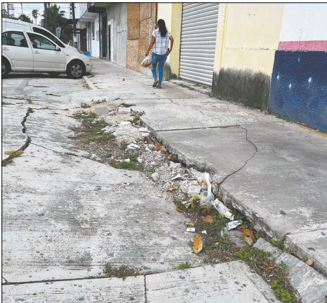
El Instituto Tecnológico confirmó la alta vulnerabilidad de la región debido a su suelo de roca caliza.
