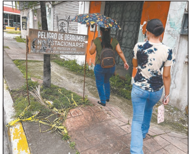
Los hundimientos sobre las aceras han provocado caída de peatones.
