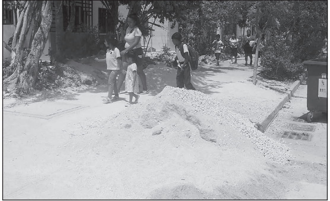
Montículos de material sobre las banquetas dificultan el paso de alumnos en la Sm 260. (Erick Romero)
