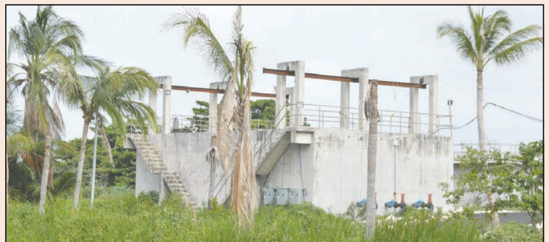
La instalación fue proyectada para procesar 230 litros de aguas residuales por segundo. (Antonio Blanco)
