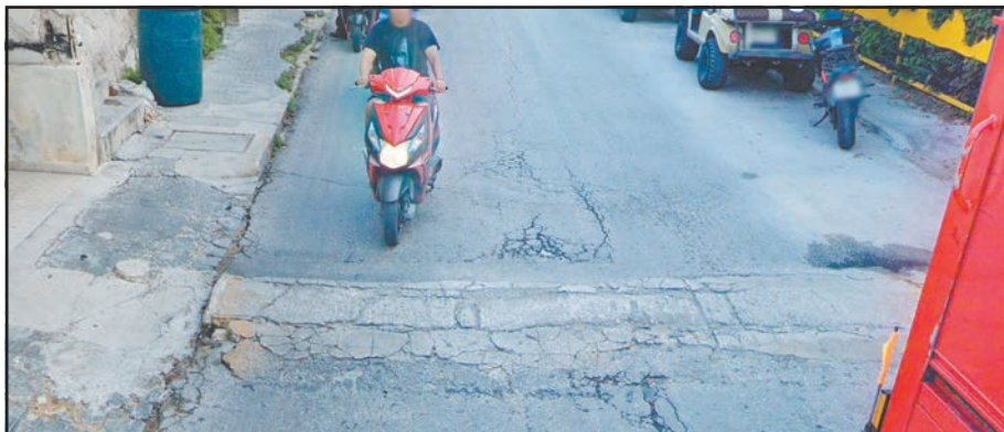
Requiere mantenimiento la carpeta asfáltica de la colonia Electricistas. (Fotos O. López)
