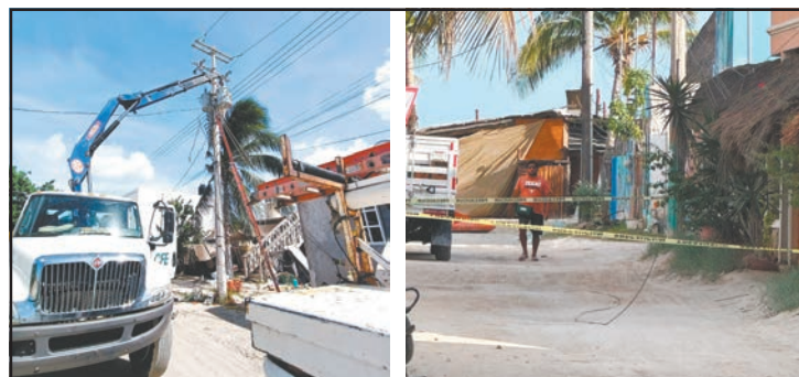
Personal de CFE dijo que se rompió una línea de tensión. (Fotos L. Cauch)
