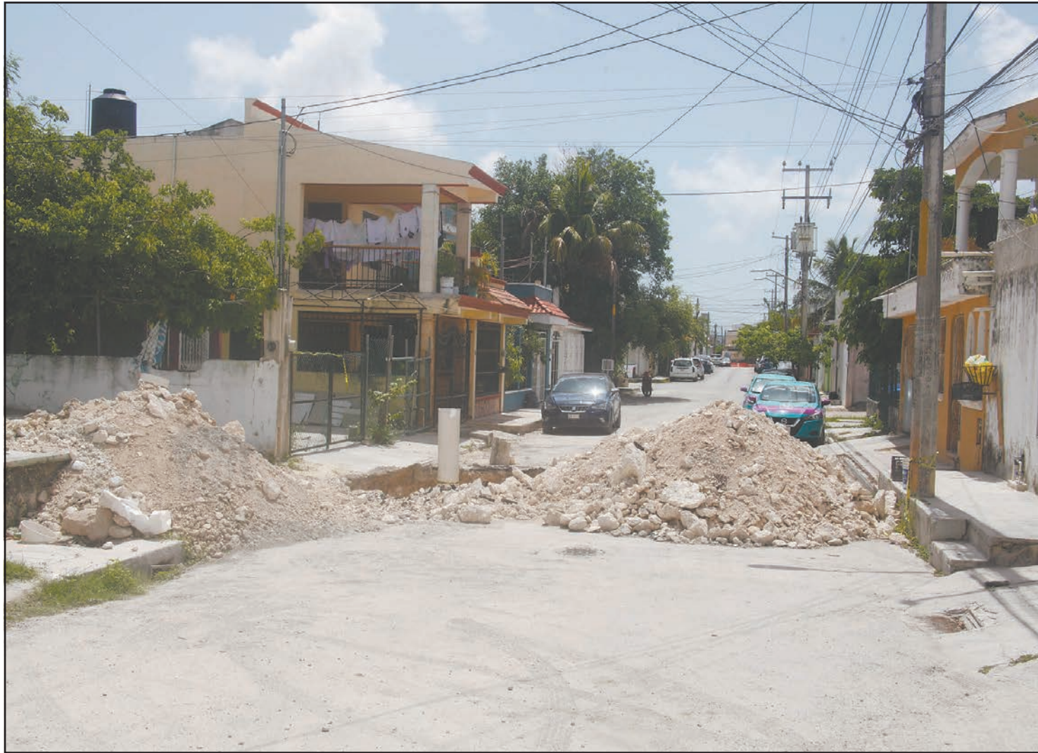
En algunas zonas el paso para peatones y autos es imposible debido a los montículos de tierra y las excavaciones de las zanjas. (Fotos E. Romero)
