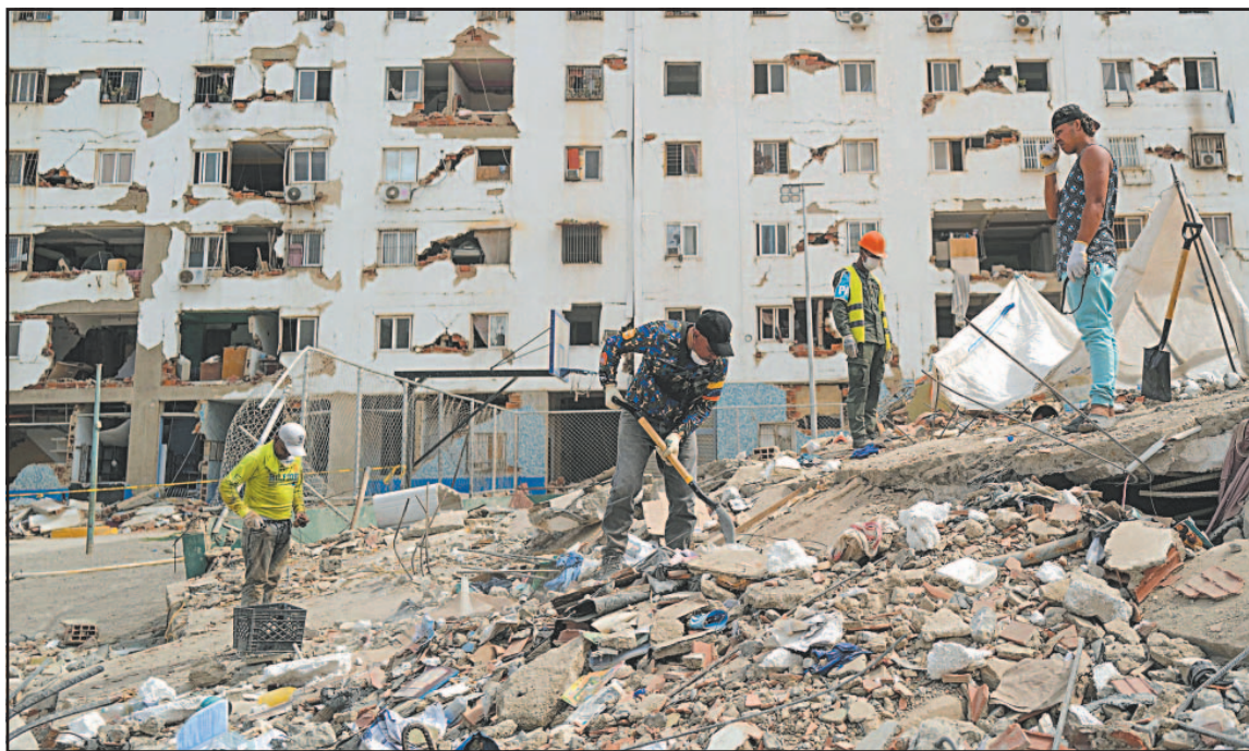
En La Guaira, a 40 kilómetros de Caracas, al menos 189 edificios colapsaron totalmente. (AFP)
