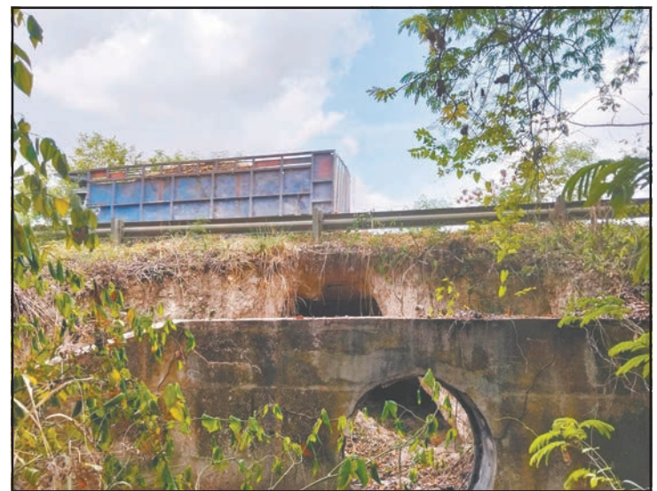
Inquieta el deterioro de la carretera Ucum-La Unión. (Fernando Olvera)
