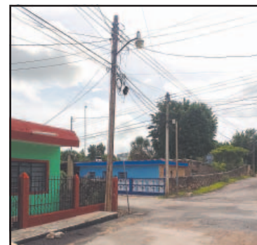
Las estructuras están deterioradas.
