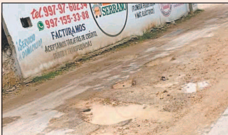
A pesar de las labores de reparación, continúan surgiendo huecos.
