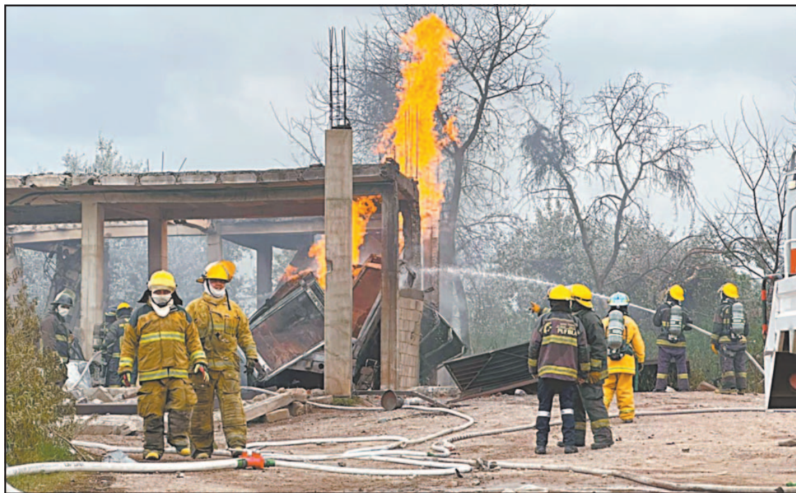
Del depósito ilegal de gas LP sólo quedaron en pie algunos castillos de concreto con las varillas expuestas.
