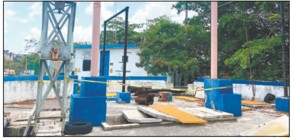
Las instalaciones siguen operando con normalidad, sin corregir las observaciones.
