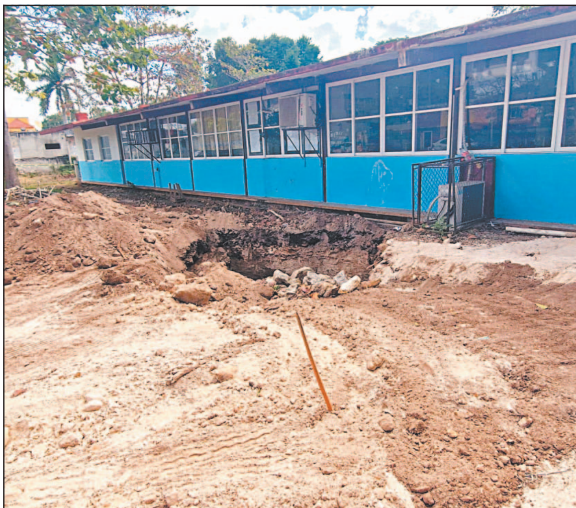
Padres de familia y directivos creen que con las lluvias los cimientos del salón cedan y se derrumben.
