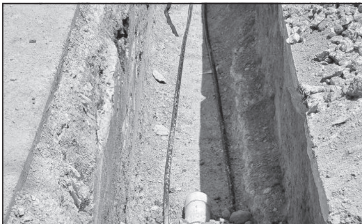
Acusan vecinos que la concesionaria dejó zanjas abiertas. (G. Escalante)
