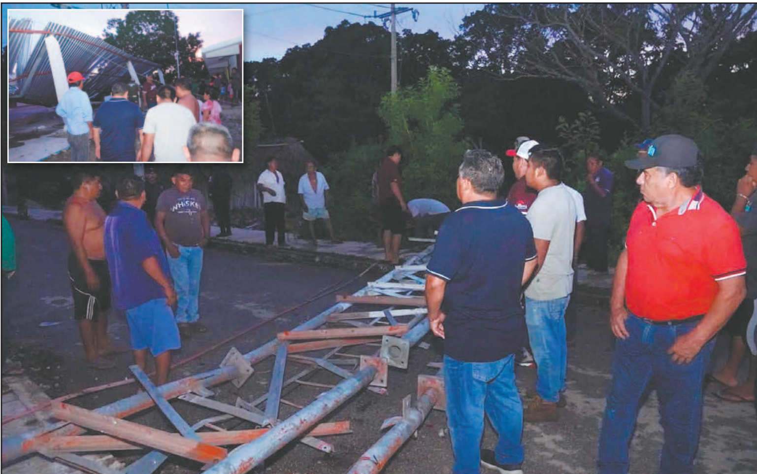
Pobladores retiraron los fierros que obstruyeron la vía a X-Querol; personal de Protección Civil resguardó el área afectada. (Fotos PORESTO!)
