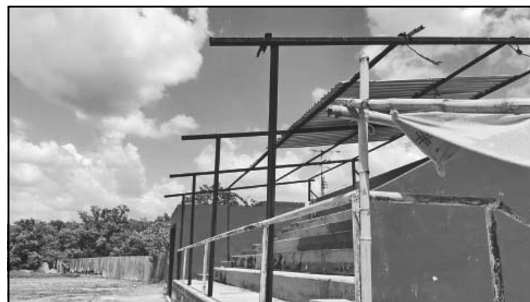
Las bancas para los equipos ya no cuentan con techo. (Erik Caamal)
