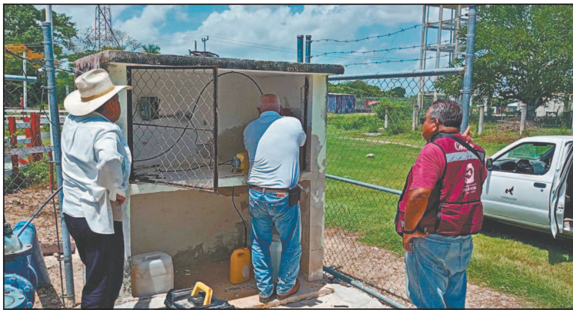
La falta de mantenimiento oportuno a las bombas ha sido la principal causa del desabasto. (Especial)
