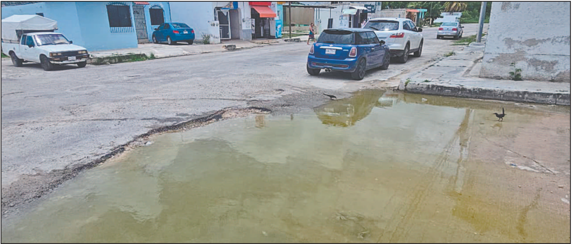
Todos los días se acumulan aguas negras que se rebosan del drenaje desde hace más de 25 años, situación que además representa un problema de salud pública. (A. Pech)
