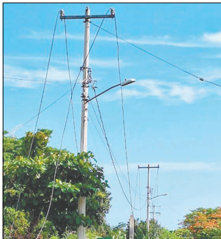
La CFE aseguró que el suministro se restableció ayer. (Lusio Kauil)
