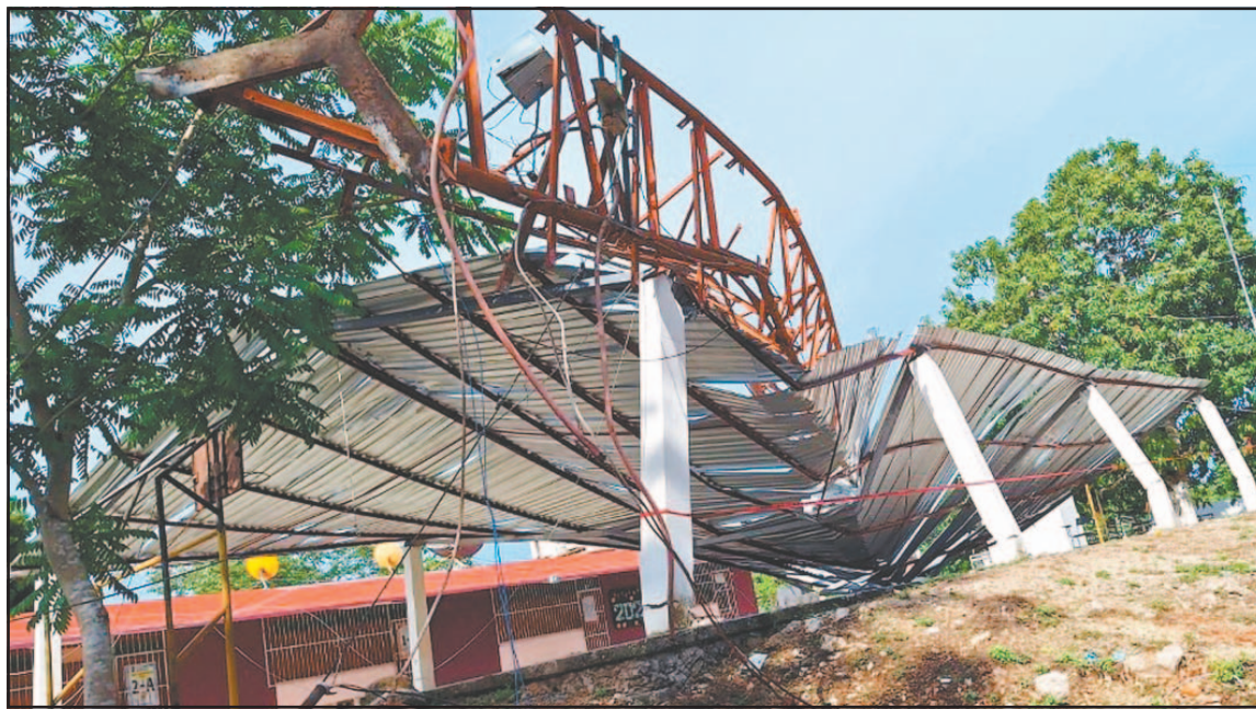
El domo del plantel “Emilio Abreu Gómez” quedó destruido por el fuerte impacto, la noche del viernes. (L. Kauil)
