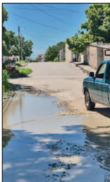
El problema se agrava porque no funciona el pozo de absorción.
