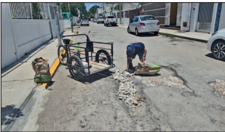
Acusan más de 40 años de deterioro y exigen obras de repavimentación.
