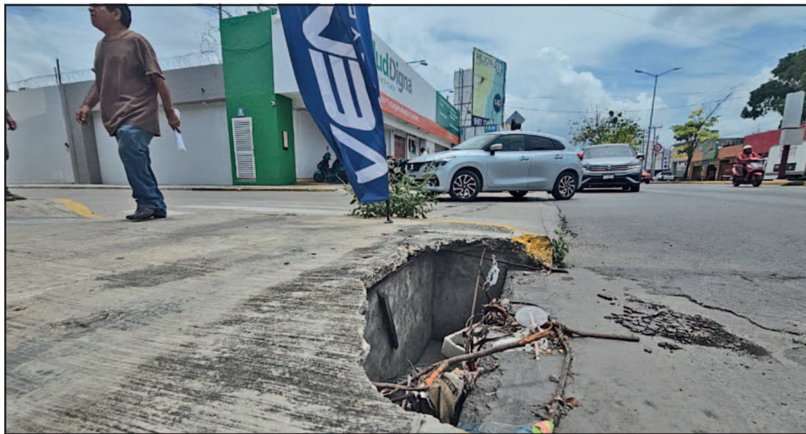
Las intersecciones de las calles 45, Chile, Argentina y Brasil concentran los mayores daños. (A. Pech)
