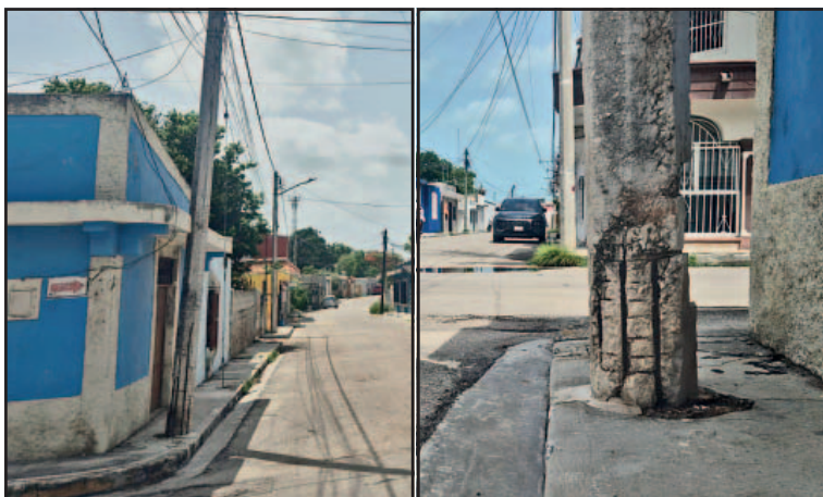
La estructura se encuentra al borde del colapso. (Jorge May Sosa)
