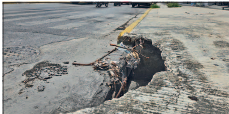
Retiran la basura acumulada para evitar constantes encharcamientos.
