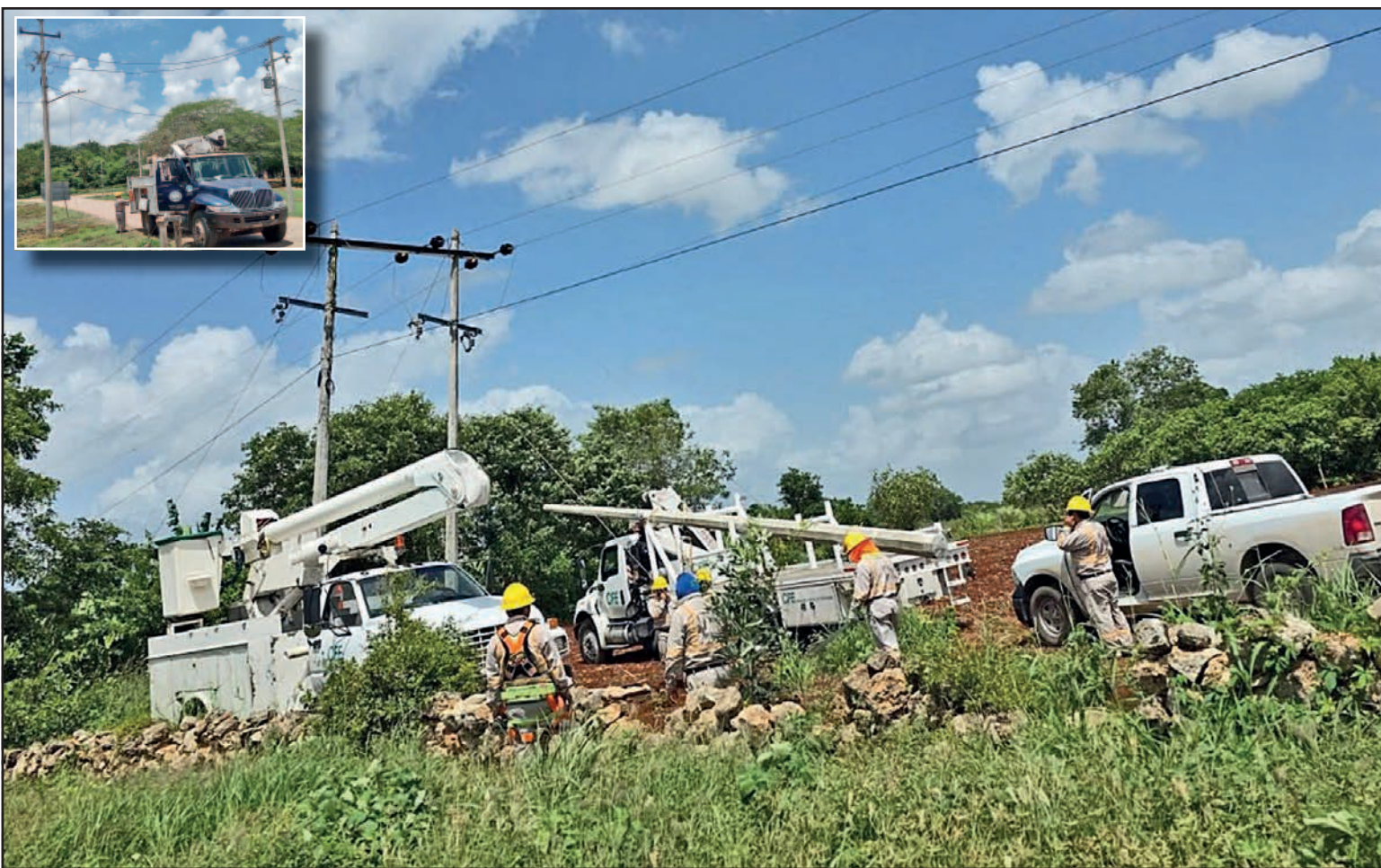
Podaron árboles y cambiaron cables junto con transformadores; hasta las 14:30 seguían sin luz y con afectaciones a la población. (M. Koh)
