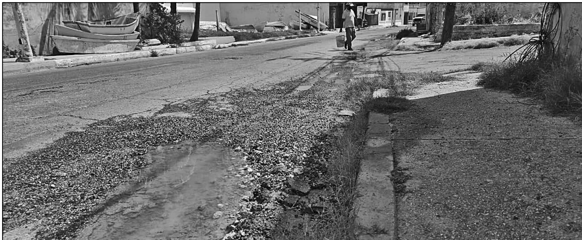
Vecinos de San Antonio, Tepeyac y Kila señalaron que el suministro es insuficiente. Las filtraciones registradas sobre la calle 20 han generado acumulación y afectaciones a la vía.
