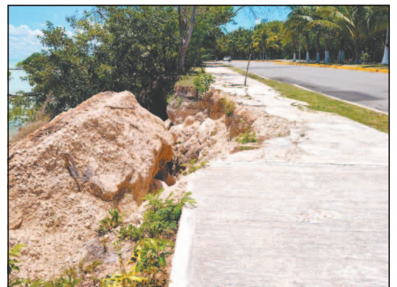
El oleaje sigue impactando los bloques de concreto. (Fernando Olvera)
