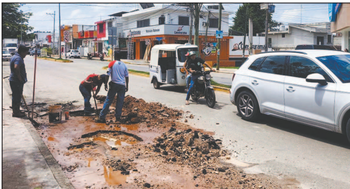
La mayor parte de la infraestructura es obsoleta, pues tiene más de 40 años de antigüedad. (Lusio Kauil)
