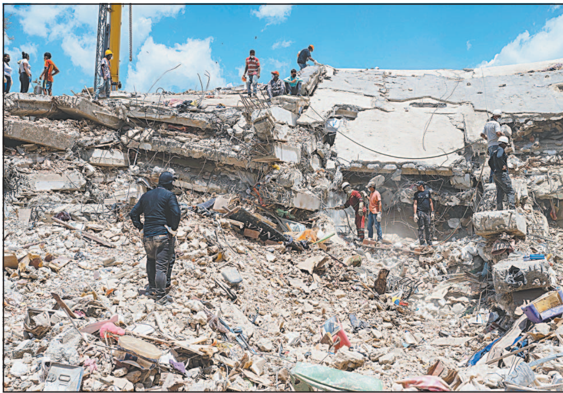
El colapso de cientos de edificios dejó más de 2 mil 200 muertos y 50 mil desaparecidos. (AP)
