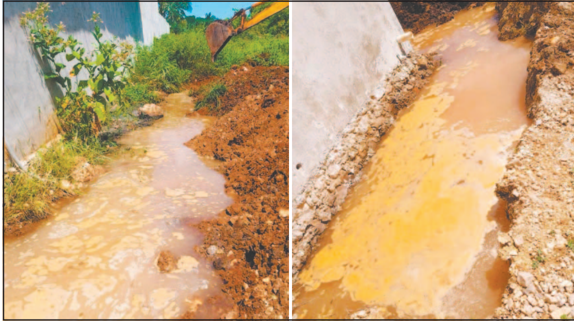
La fractura de la tubería principal causó una fuga intensa, por lo que se cerraron las válvulas. (Fotos E. Cauch)
