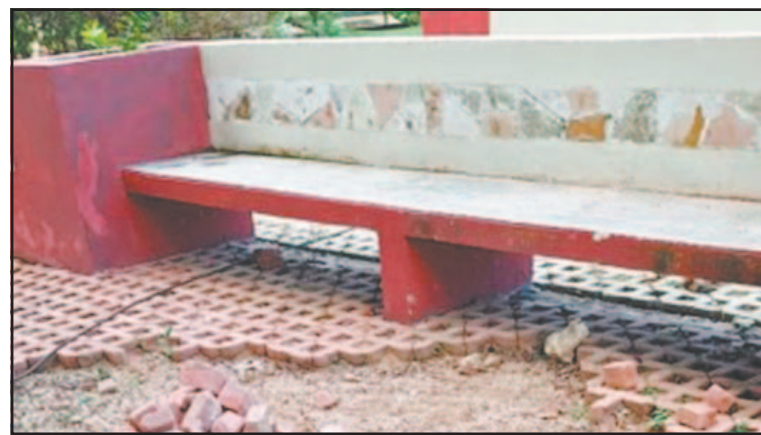
Varias partes del adoquín están deterioradas y levantadas. (Lusio Kauil)
