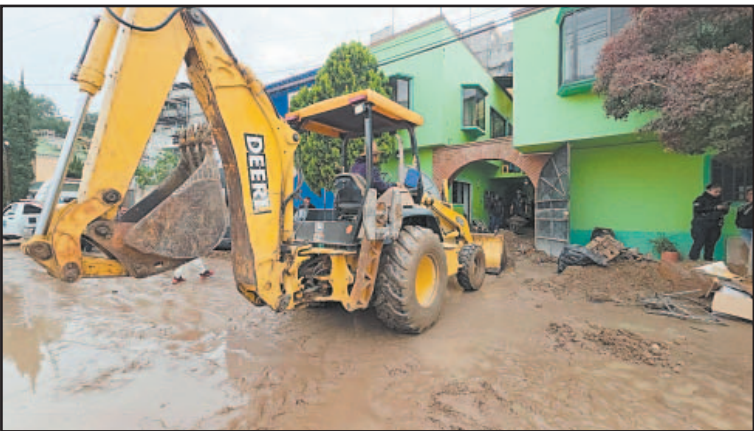
Las toneladas de lodo descendieron al interior de las viviendas. (Agencias)
