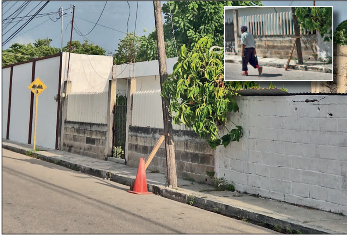
Solo un puntal detiene a la maltrecha estructura de madera que está a punto de colapsar. (Jorge May)
