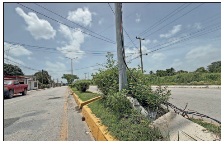
Además de su base, algunos tienen los cables de fuera. (Jorge May)
