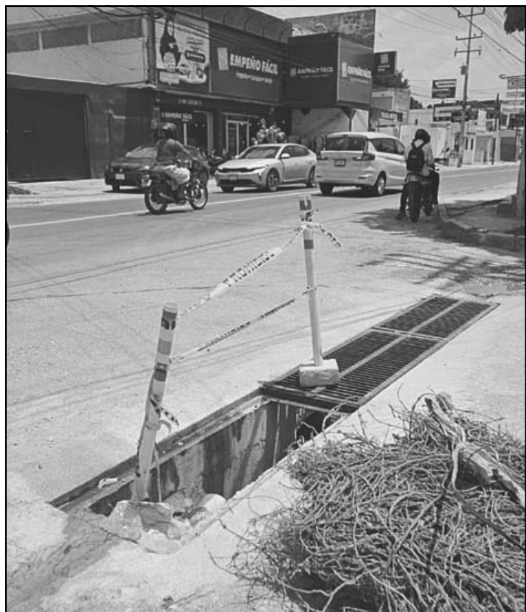
Residentes solicitan ampliar el sistema para evitar encharcamientos.
