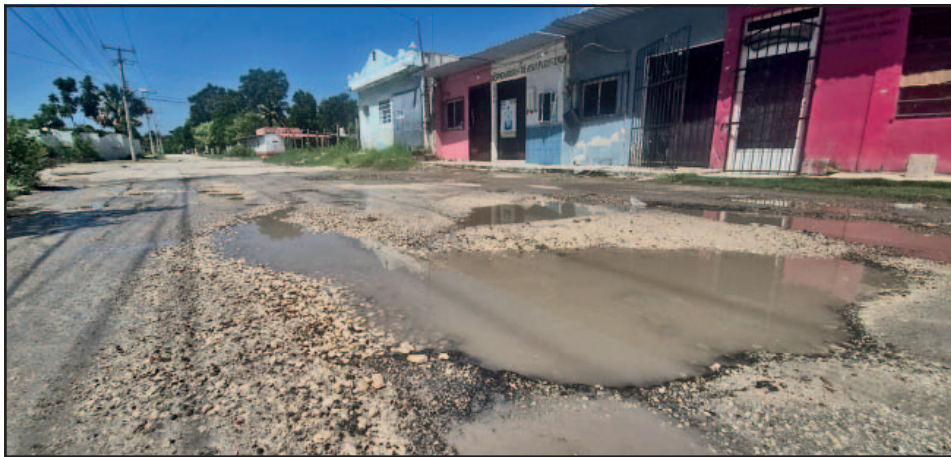
Las fugas de agua son la principal causa de que se rompa el pavimento. (Jorge May)
