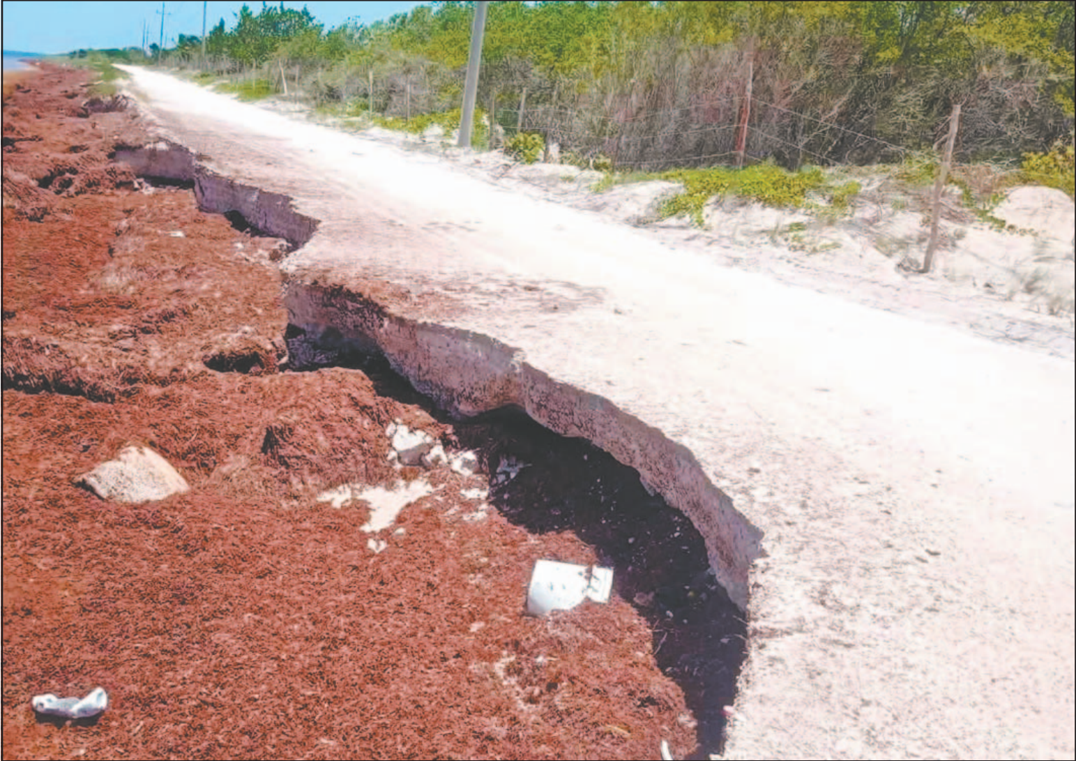
El oleaje constante y la acumulación de macroalgas causaron ya la pérdida de casi un carril de circulación. (Fotos Fernando Olvera)
