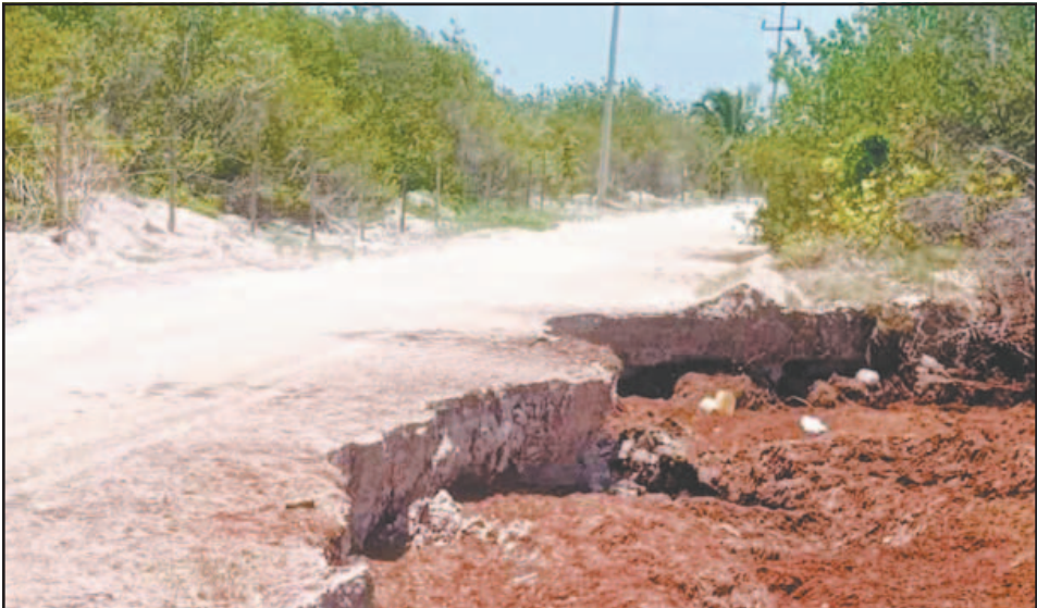
Cuando llueve, habitantes de ranchos cercanos se quedan varados e incommunicados.
