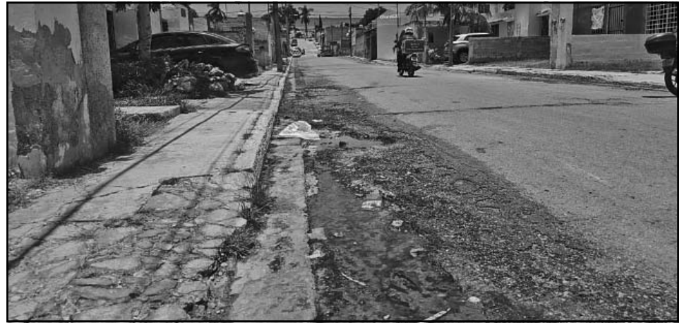
Piden obras de saneamiento para evitar problemas derivados de aguas estancadas.
