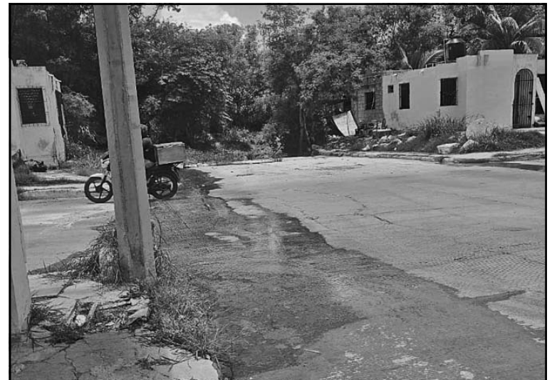
También, alertaron sobre el mal estado de postes de alumbrado.
