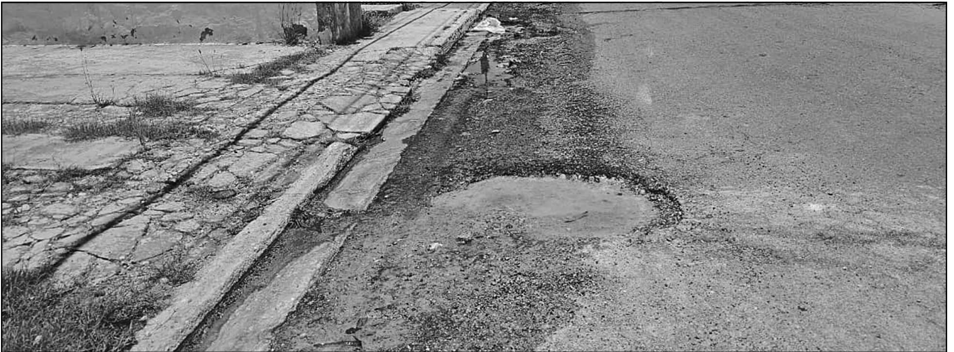
Residentes señalaron la presencia de verdín, pavimento deteriorado, escarpas dañadas y acumulación de aguas con malos olores en diferentes puntos de la zona. (A. Pech)
