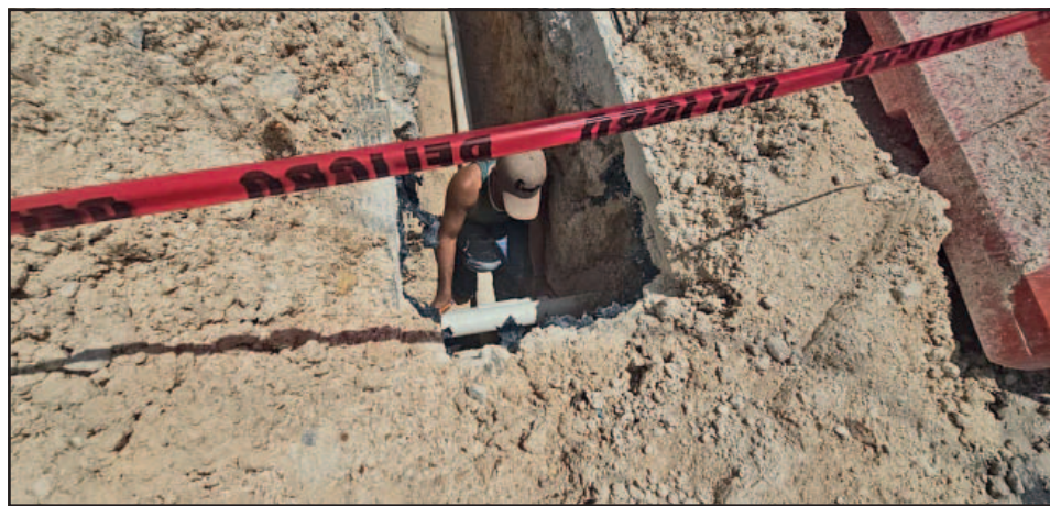
Las constantes aperturas del pavimento han provocado la aparición de nuevos baches.
