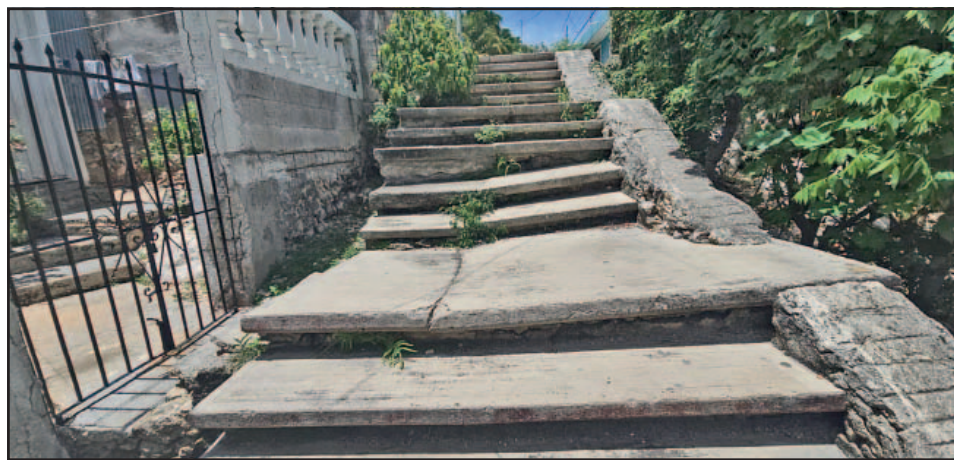
La falta del sistema pluvial provoca acumulación de agua durante la temporada de lluvias.
