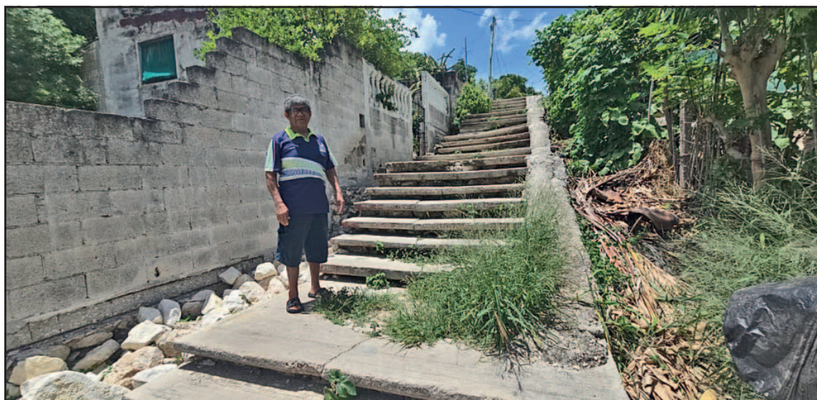
Habitantes recorren andadores deteriorados con grietas, hundimientos y falta de mantenimiento.
