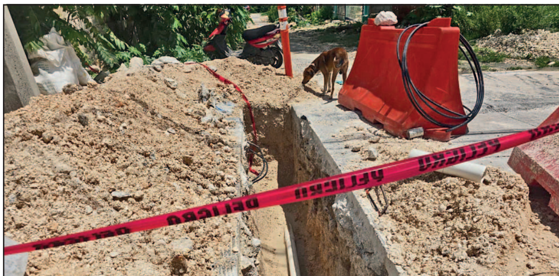
Los habitantes acusan interrupciones del suministro y daños en calles tras trabajos de la SMAPAC.
