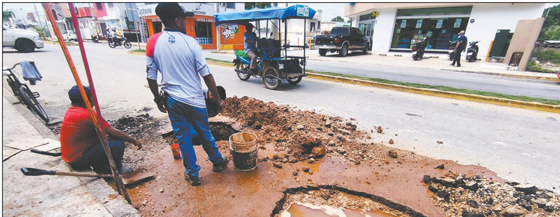
Ciudadanos exigieron renovar la infraestructura hidráulica obsoleta. La CAPA asegura que los desperfectos ocurren en los tramos donde aún hay ductos de asbesto. (Lusio Kauil)
