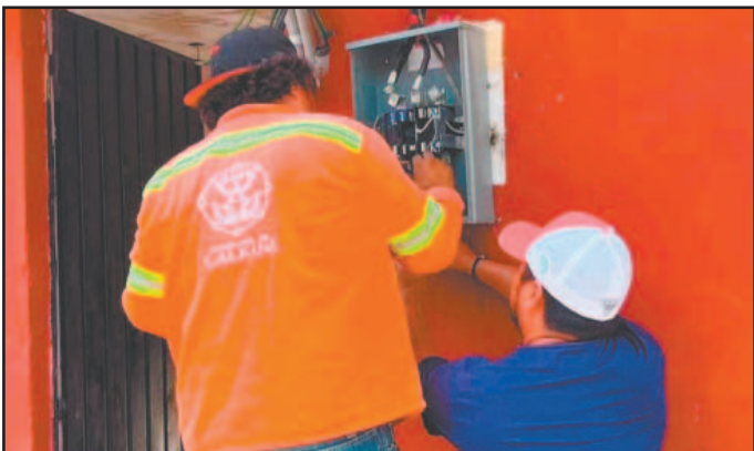
UNA variación de energía quemó el sistema de bombeo en la Junta de Nunkiní y obligó a suspender el servicio hídrico a la mitad del poblado.- (Erik Caamal)
