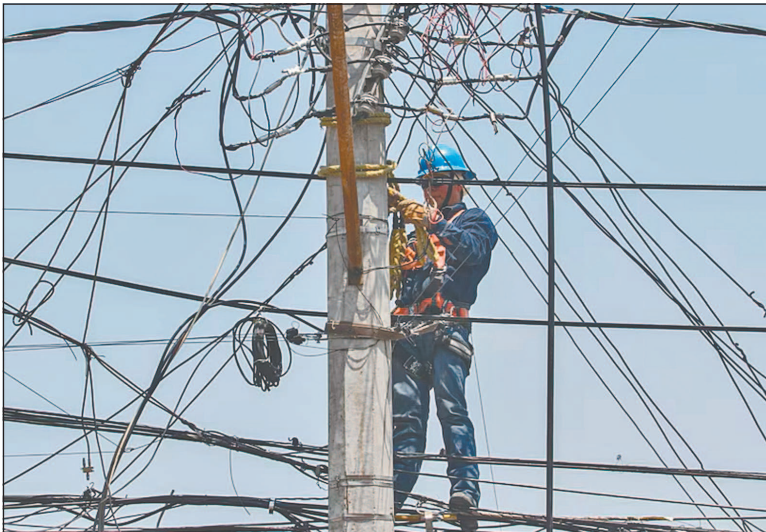
Las tomas irregulares son un problema recurrente que provocan sobrecargas, incendios y fallas en el suministro. Piden denunciar. (Especial)
