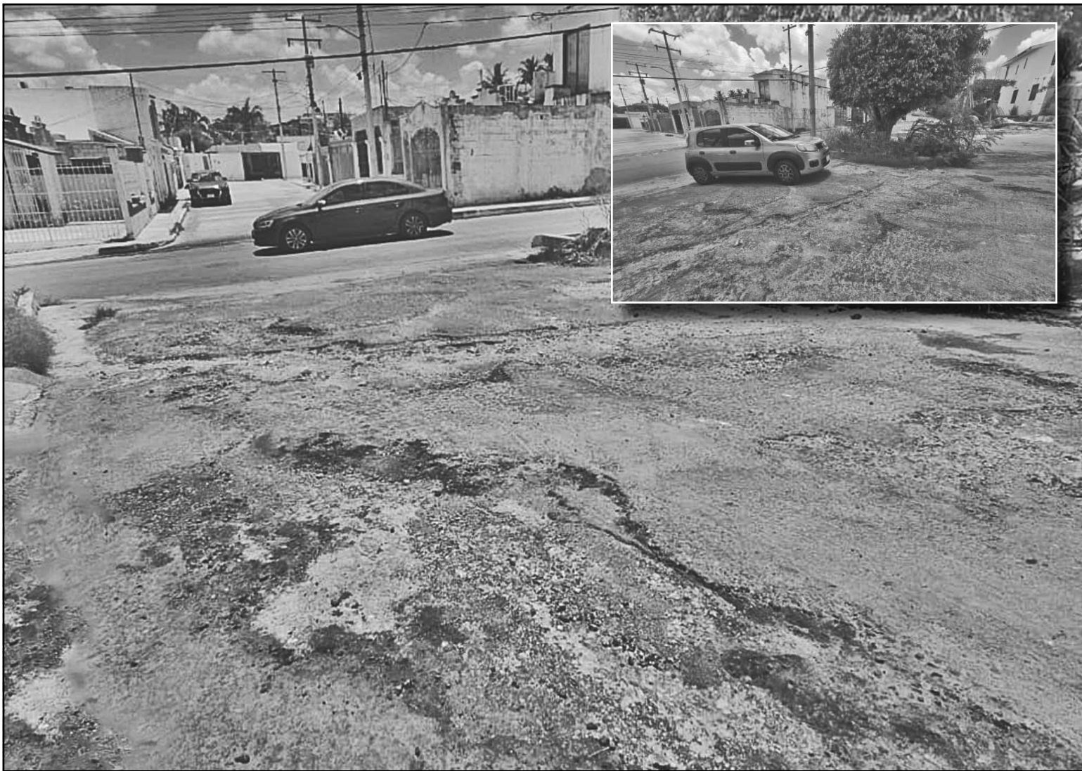
Los residentes rellenan de vez en cuando los hoyancos para que no se les dañen sus vehículos, debido a la indiferencia de la Comuna.
