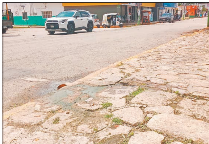
CAPA no ha acudido pese a estar a menos de 100 metros de la afectación.
