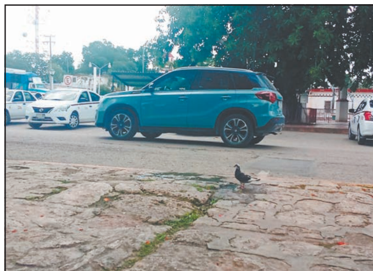
Taxistas dijeron que son dos sitios en los que hay pérdida de líquido.
