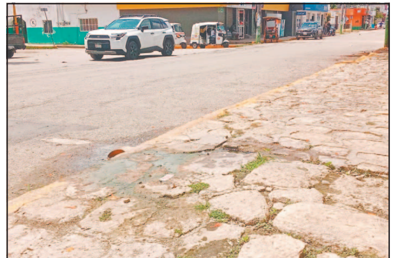
CAPA no ha acudido pese a estar a menos de 100 metros de la afectación.
