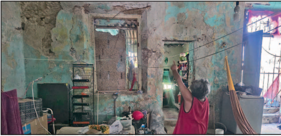
Tras décadas de historia, el deterioro obliga a sus ocupantes a vivir con incertidumbre.
