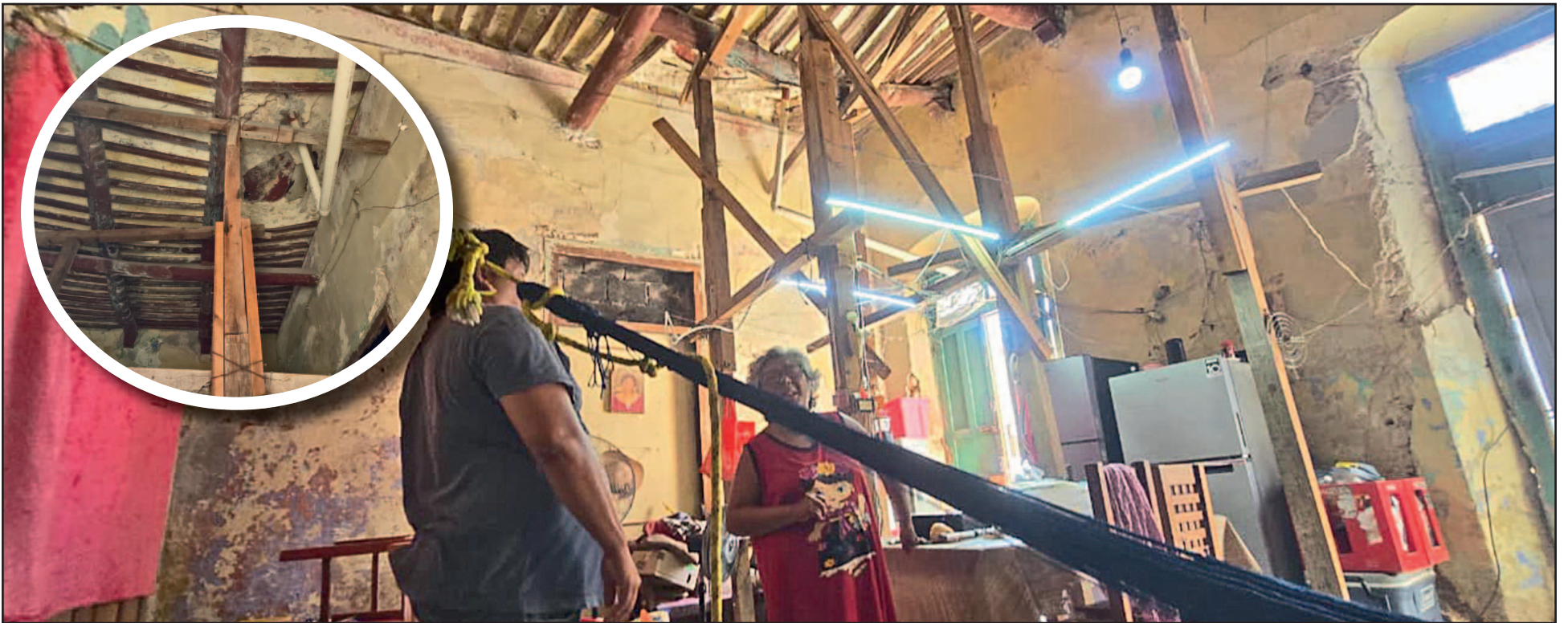
Una estructura de madera fue instalada para evitar que la cubierta colapse sobre los ocupantes del predio, mientras la familia espera reunir recursos para intervenir su casa.
