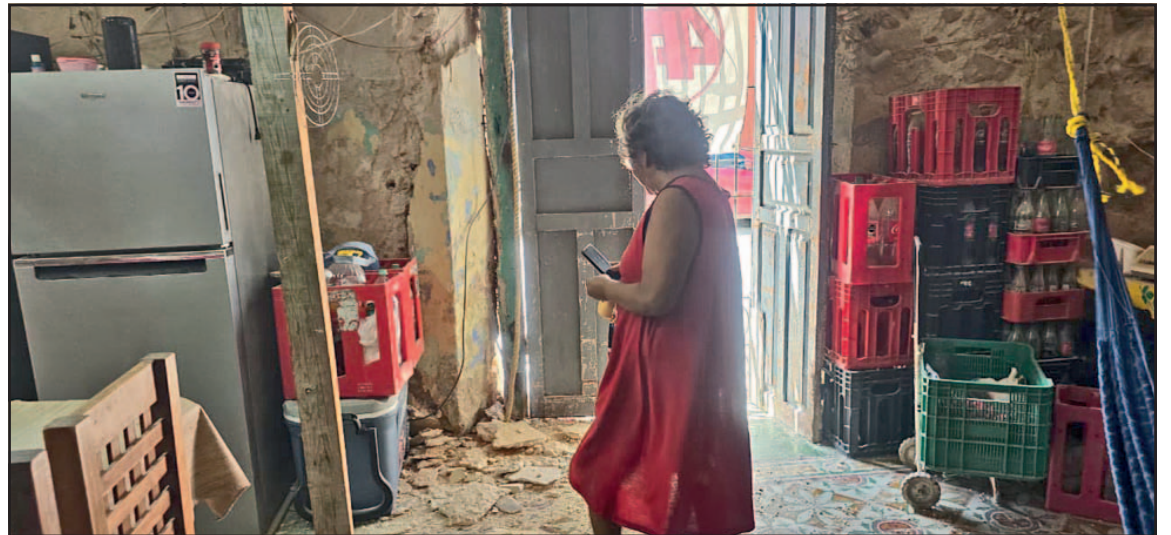
Grietas y desprendimientos evidencian el avanzado desgaste que presenta la vivienda. (Alejandro Pech)
