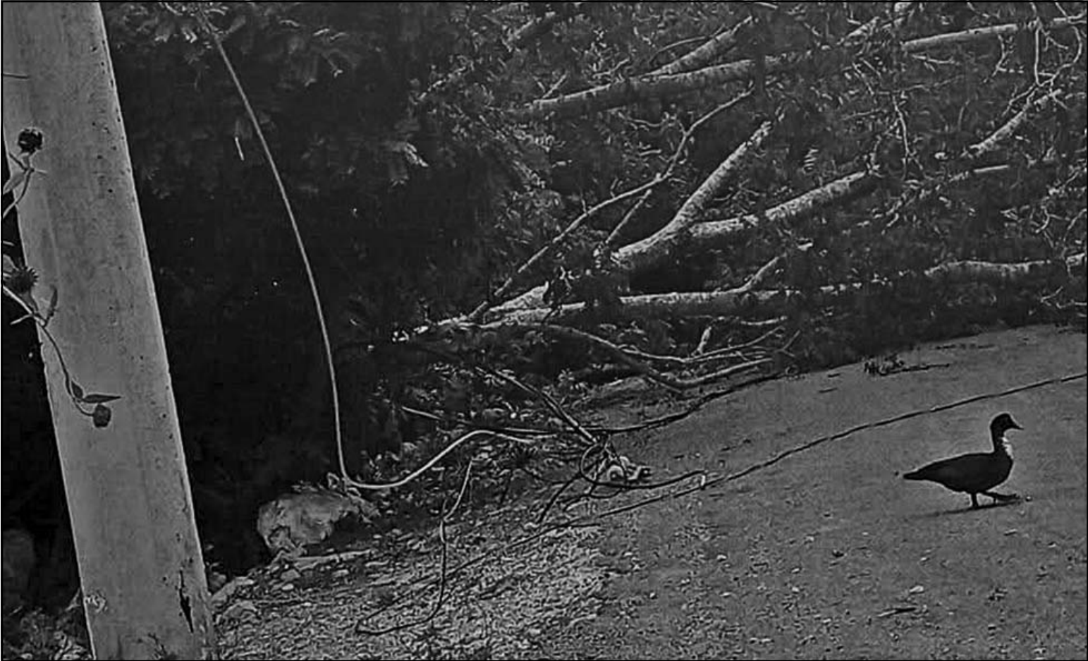
Desde el momento en que ocurrió el incidente la gente llamó a la Comisión para reportar la cablería rota. Siguen esperando. (Erik Caamal)
