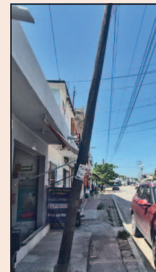
Advierten que es un peligro en la zona. (J. May)
