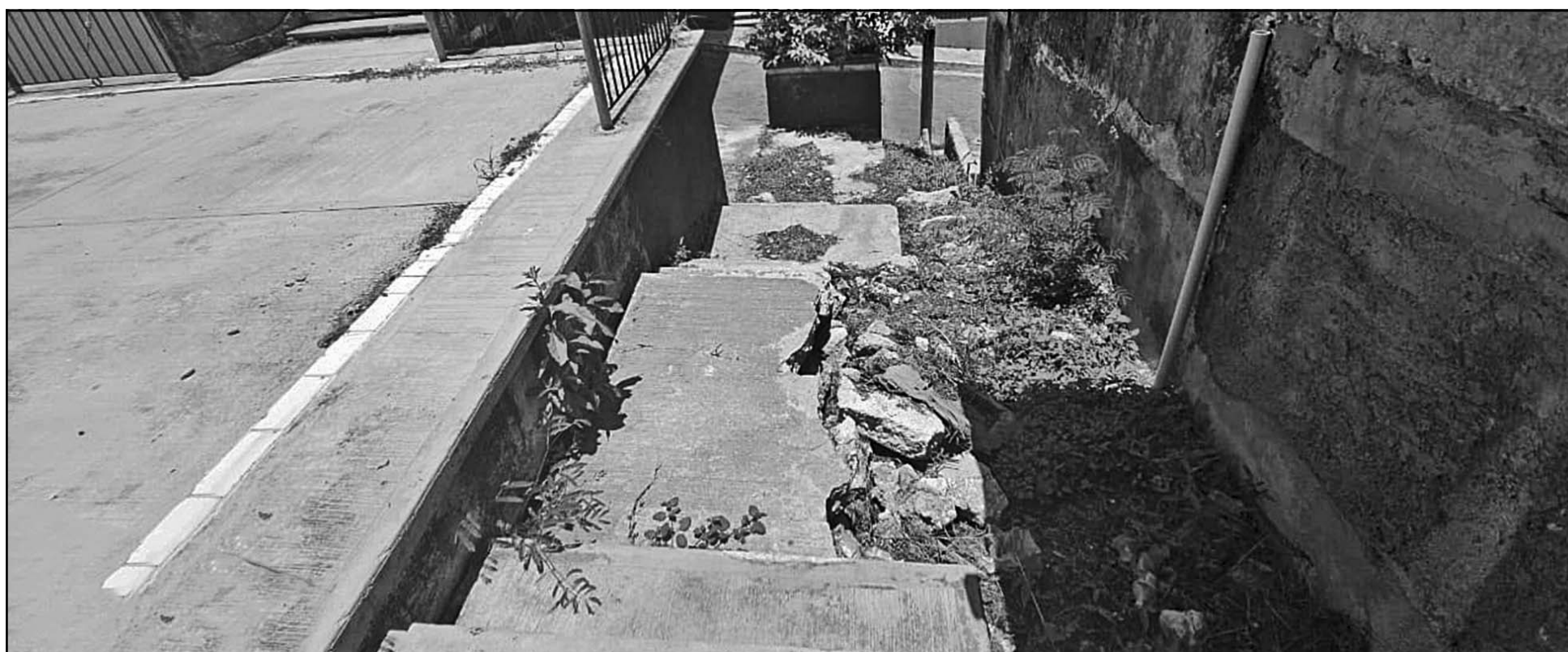
Residentes acusan abandono de los espacios públicos y piden al Ayuntamiento de Campeche reparar la entrada por la presencia de baches y terracería. (Alejandro Pech)
