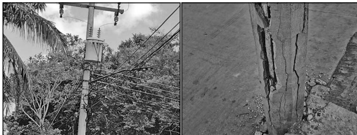
Postes rotos y transformadores que ya vencieron su vida útil son factores para los apagones. (M. Koh)
