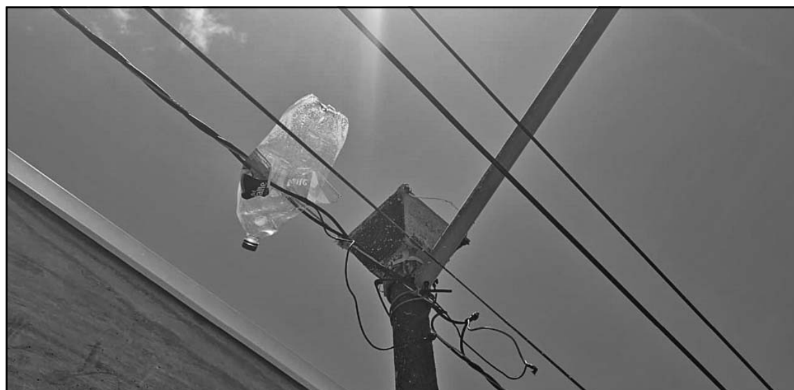
Denuncian que una botella PET fue utilizada para separar cables durante la reparación del sistema de iluminación.
