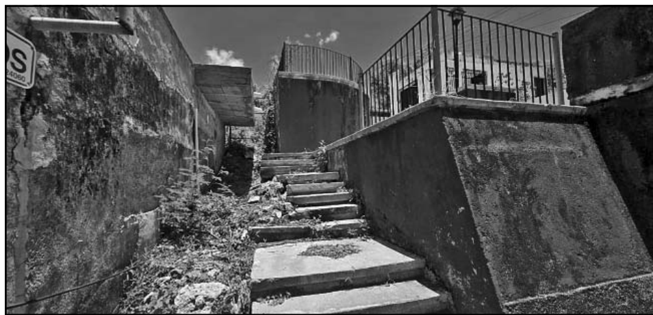
El deterioro de la estructura obliga a los peatones a transitar con precaución por el paso.
