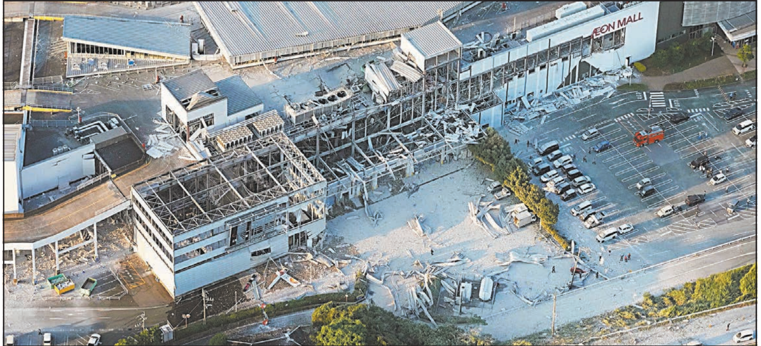
Las autoridades desconocen la cifra real de empleados y personas que estaban en el edificio en el momento del temblor. (AP)
