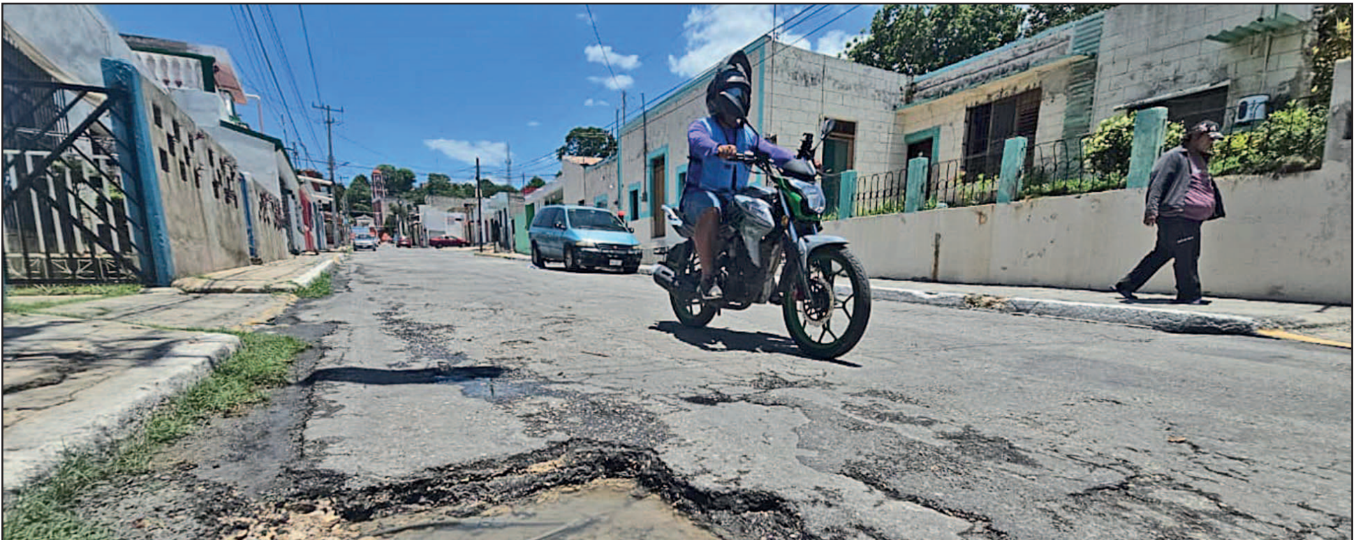
Los afectados atribuyen las fallas a los trabajos realizados para la instalación de la nueva tubería en la avenida Héroe de Nacozari; también afectó a el barrio Santa Ana.
