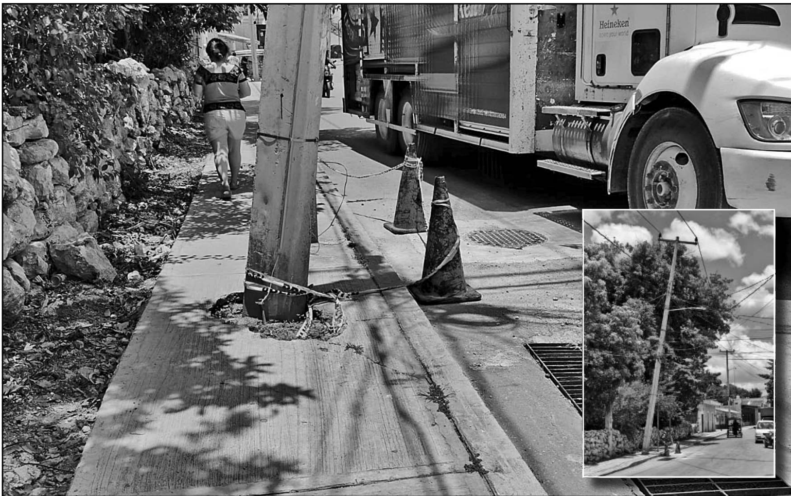
Las autoridades colocaron cinta amarilla a manera de prevención, pero el riesgo de desplome aumenta todos los días. (Erik Caamal)
