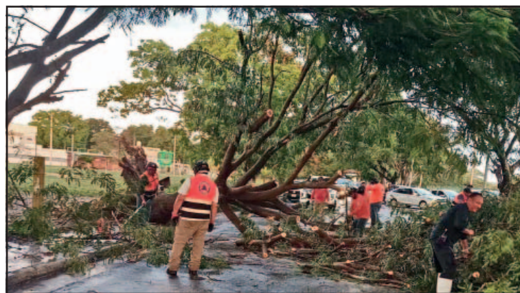
Las líneas eléctricas también resultaron afectadas por los desplomes.
